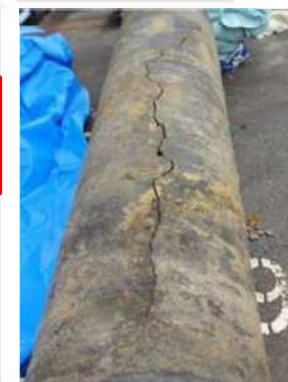
破裂した鋳鉄管 (500mm)
