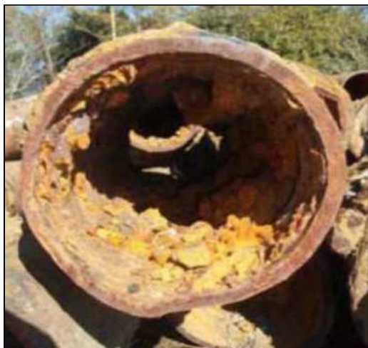
経年化による内面腐食
