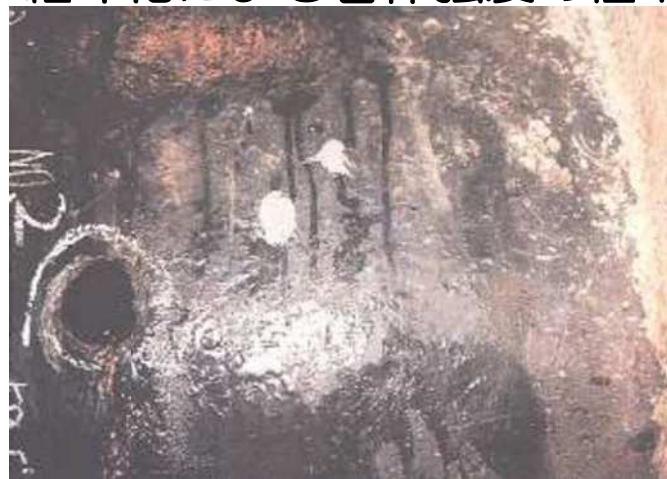
鋼管の局部腐食
