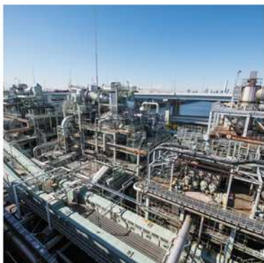
汚泥処理施設
