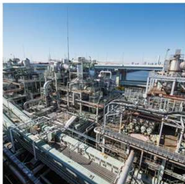
汚泥処理施設
