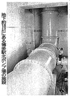
地下約18mにある博多北ポンプ場の施設
