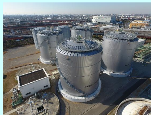
鋼板製消化タンク
