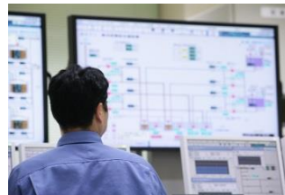
中央監視室では運転状況のモニタリングを行います。
