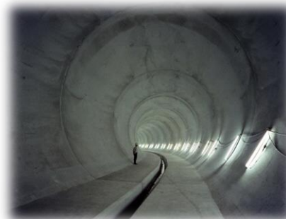
浸水から街を守る 雨水幹線
