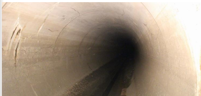
▲渋川雨水貯留管
