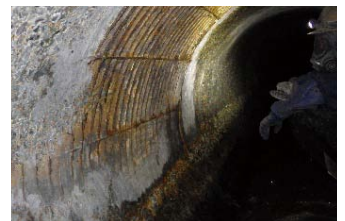
▲腐食した下水道管きよ
